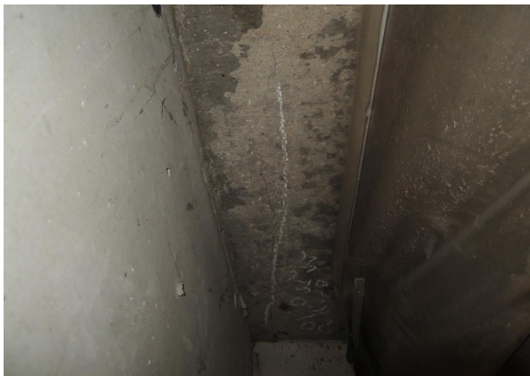
S1 바닥판 하면 균열(0.3mm/0.8m)
