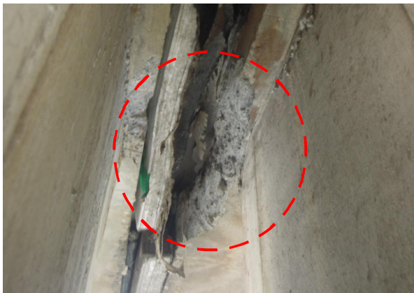
S3 바닥판 하면 파손(0.5m×0.2m)
