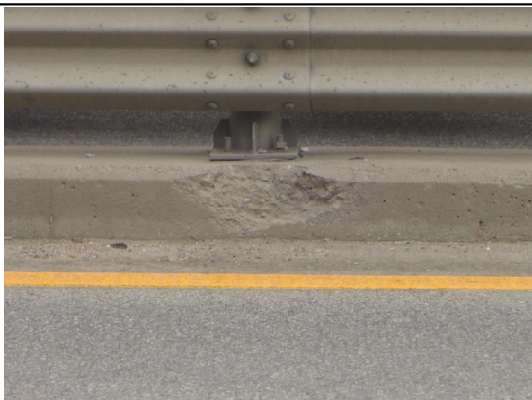
S9 중앙분리대 연석파손(0.5m×0.5m)
