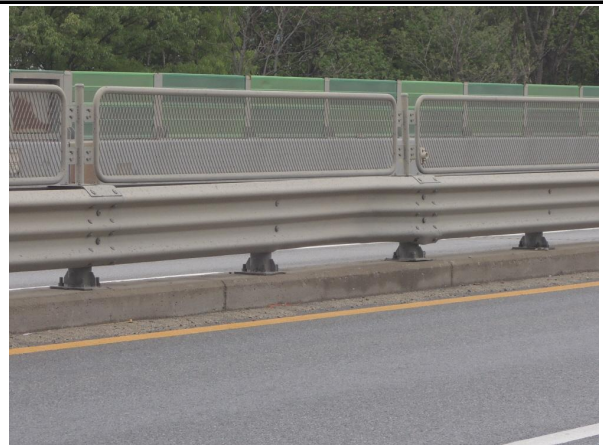
S6 중앙분리대 가드레일변형(L=2.0m)
