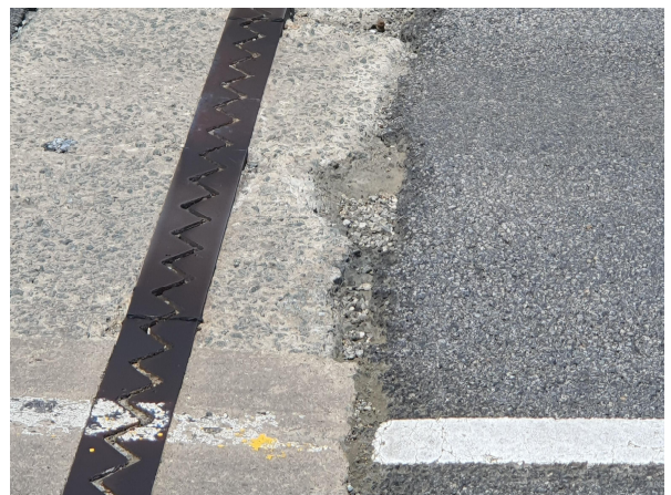
A1 신축이음 후타재 파손(0.2m×0.2m)
